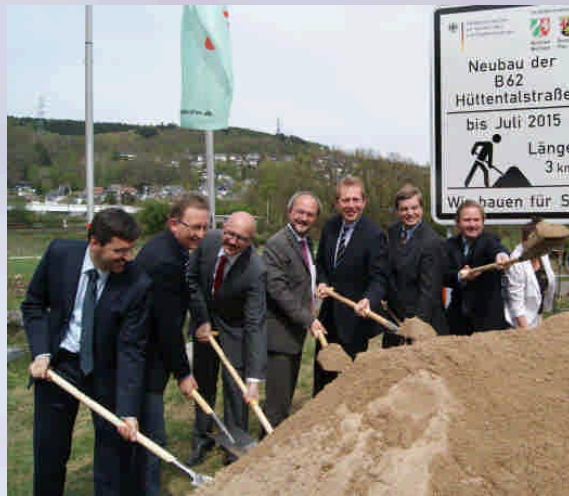
Zum ersten Spatenstich für den Weiterbau der Hüttentalstraße/B62 war aus Berlin der Parlamentarische Staatssekretär Enak Ferlemann gekommen.
